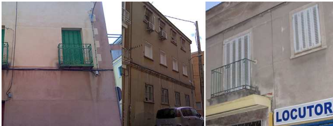
Figura 15: Ejemplos de lesiones en fachadas. Fuente: Elaboración propia.
