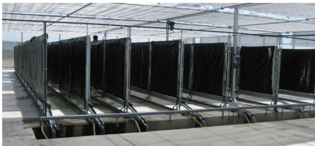
Figura 5. Vista de la planta experimental de producción de microalgas mediante el sistema PBRL en Valdecañas (Palencia). Se observan diversas filas de 10 paneles cada una con diversas separaciones entre ellas al objeto de estudiar la influencia de este parámetro sobre la producción de microalgas.
