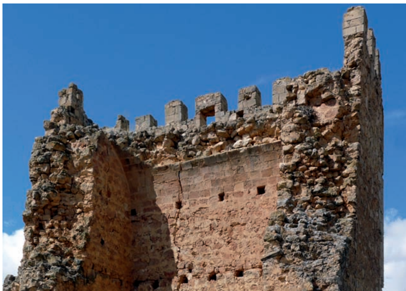
Figura 6. Detalle de la coronación de la torre, donde se observa el remate almenado con el hueco de acceso al cadalso de madera perimetral así como la bóveda de cantería y los mechinales de apoyo de la cimbra (fuente: IJGC).
