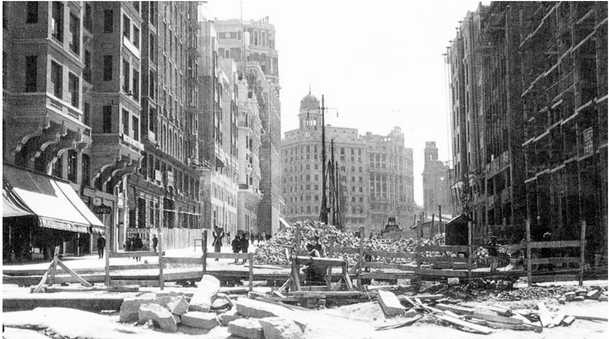
Fig. 5. La calle totalmente levantada a causa de las obras. 1912. [Archivo Municipal Madrid].
