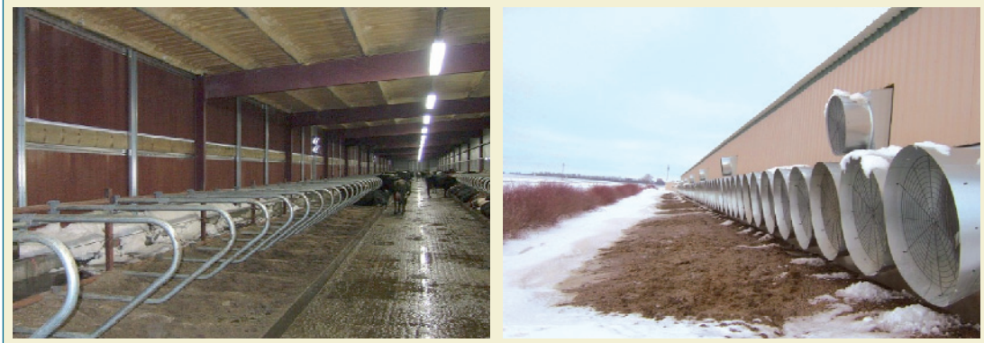
Figuras 2 y 3. Refrigeración mediante paneles humectantes y extracción mecánica de aire.
