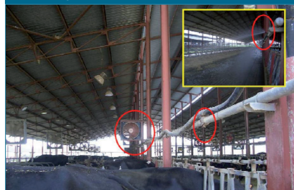
Figura 5. Rociadores y ventiladores
