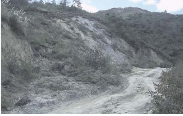
Foto 2. Deslizamiento rotacional en la trocha carrozable Santa Rosa de Unanca-Llanavaco.
