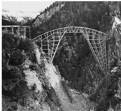
Figura 20. Fotografía de la cimbra empleada para la construcción del puente de Salginatobel (R. Maillart).
