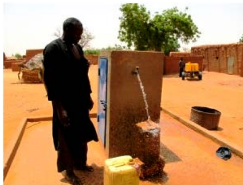
Figura 28. Punto de agua. Fuente ACH [11]
