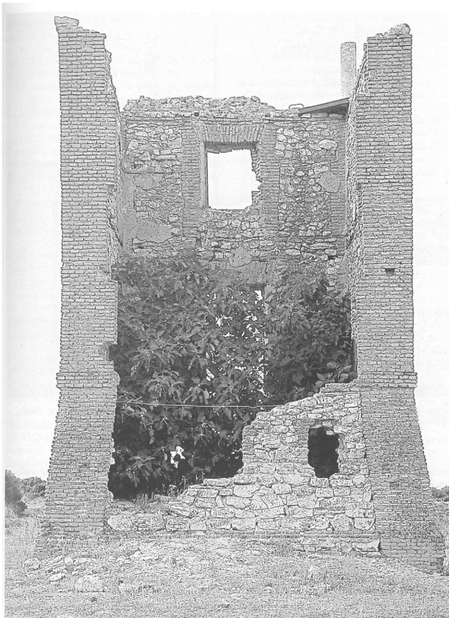
Vista del interior semiderruido.
