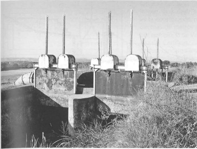
Compuertas en el canal previo a la entrada al pueblo.
