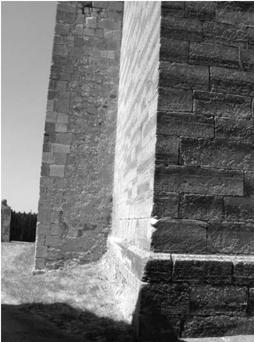
Figura 7 Esquina muro sur - muro oeste. Se observa la disminución en la sección cierta altura sobre rasante
