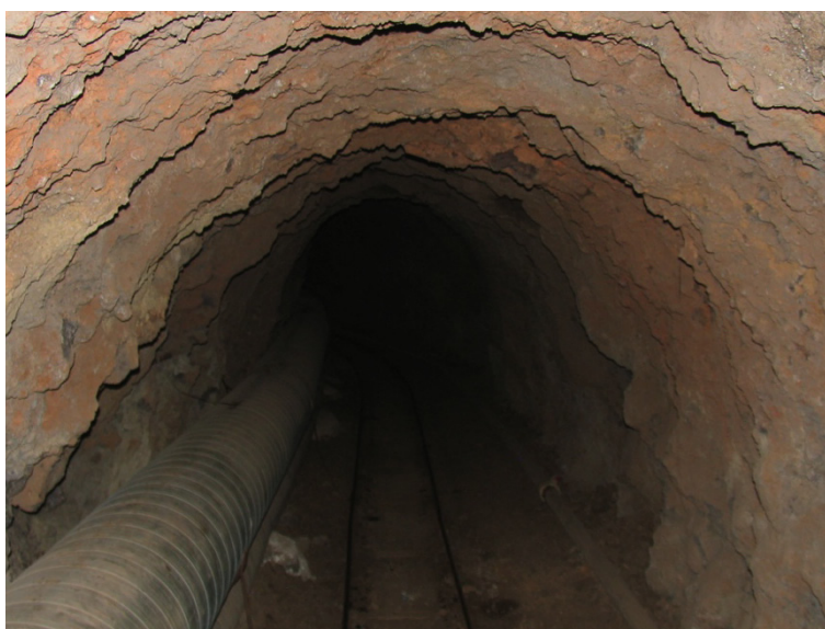
Figura 5 ; sección de una galería en el Sur de la isla de Tenerife, se puede observar la falta de elementos para sostenimiento de la sección, habitual en perforaciones en terrenos volcánicos , salvo que nos encontremos en zonas de fanglomerado (superficie de un gran deslizamiento), materiales más fluidos como las pumitas, caída de prismas basálticos, coladas de piroclastos , etc....
