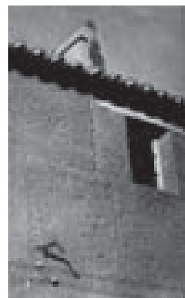
10.216. Muros de tapial según la construcción tradicional de la artesanía popular preindustrial en Tierra de Campos; Gonzalo de Cárdenas, Reconstrucción, n.8, 1941.
