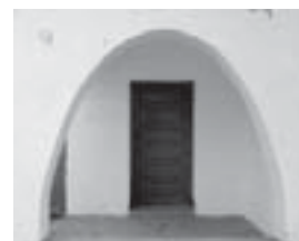
10.217. Portal de acceso con arco que no se corresponde con la existencia de una bóveda detrás en el nuevo pueblo de Rincón de Ballesteros, Cáceres, C. Sobrini Marín, 1953; por el autor de la tesis.
