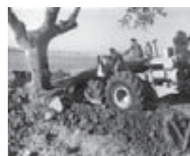
4.104. Labores de explanación de terrenos y arrancado de árboles en la provincia de Badajoz, década de 1940. Arch. Ministerio de Agricultura.
