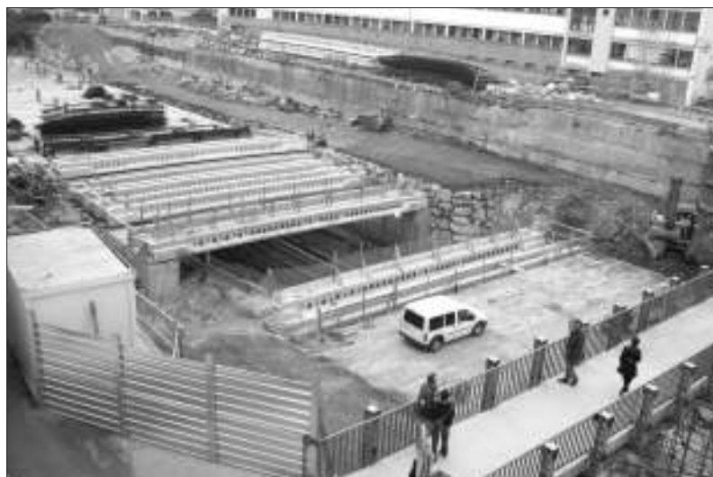
Figura 17. Aspecto de la trinchera tras demoler el Pont-Vieux e instalar una pasarela peatonal provisional
