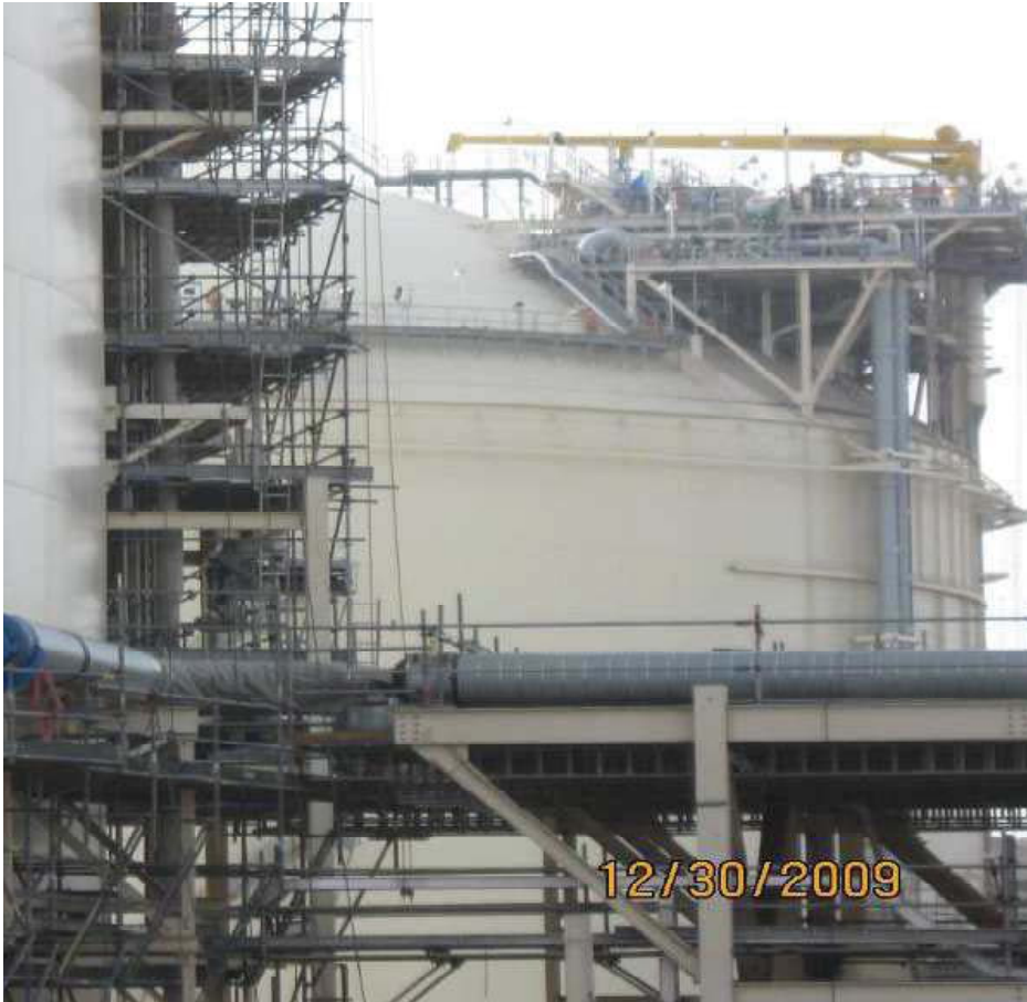
Tuberías de entrada y salida del GNL y otros productos, con sus soportes y plataforma
