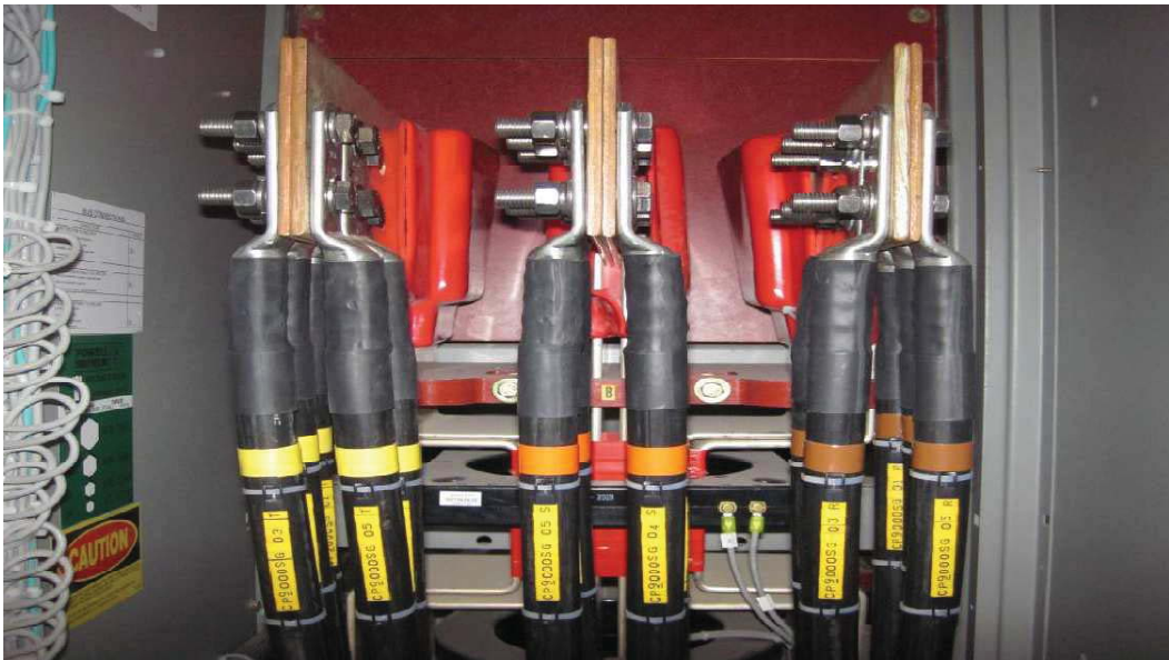
Terminaciones de cables de potencia (bombas)
