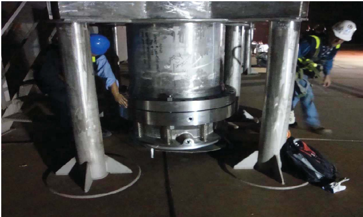
Montaje de la válvula del fondo del tanque (bomba de GNL)
