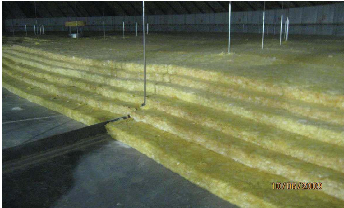
Mantas de lana de vidrio sobre el techo suspendido
