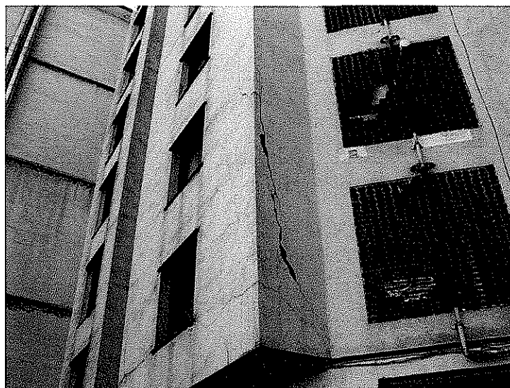
Fig. 3: Ejemplo de daños graves en un cerramiento por deformabilidad excesiva
