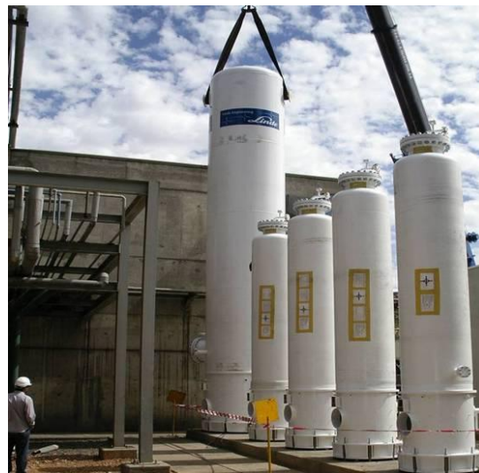
Figura 6. Detalle de la unidad de purificación de H 2 (Unidad PSA)
