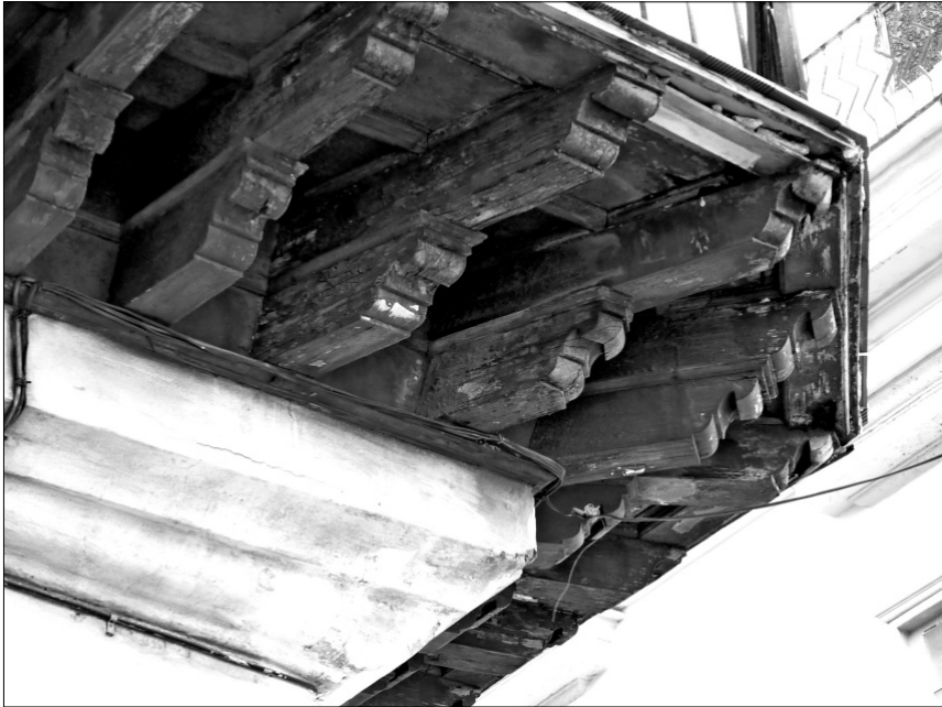
FIGURA 5: Canes dobles y vistos de la Casa del Conde de Casa Barreto (ca. 1732), restaurada en 1979 por Daniel Taboada.
