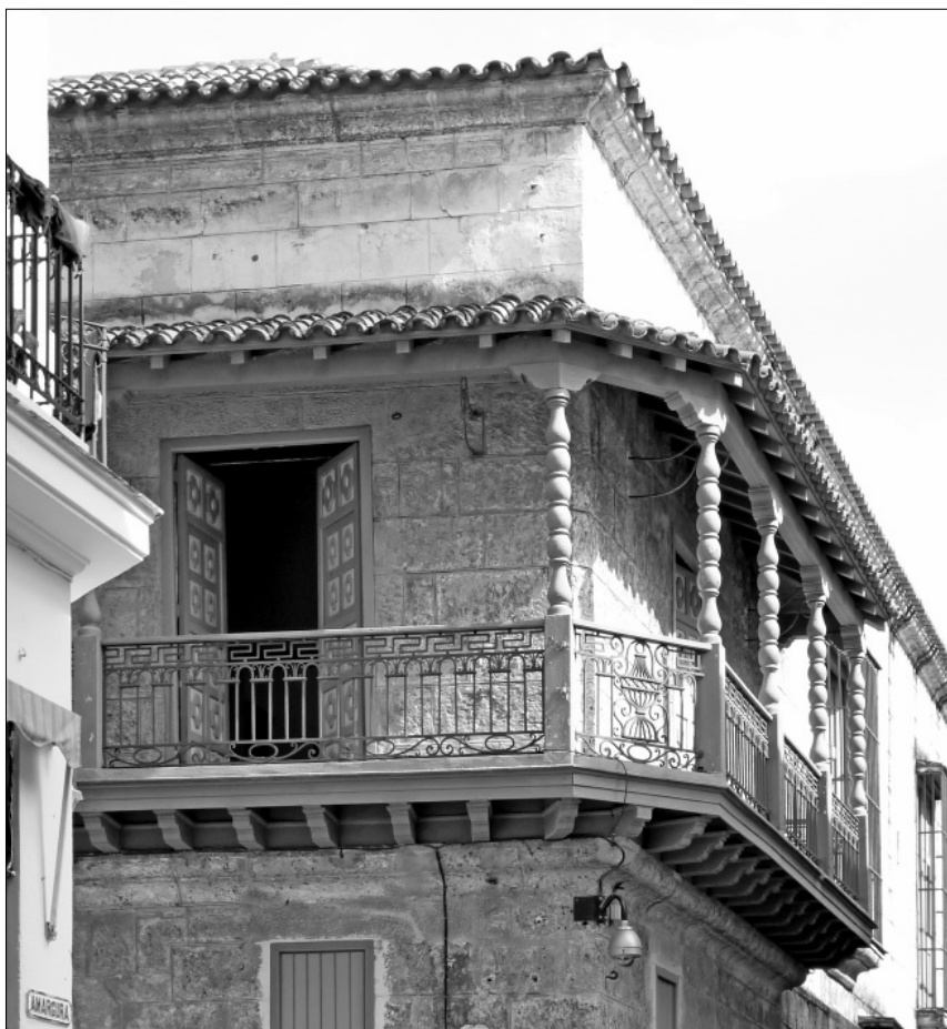
FIGURA 3: Balcón habanero que ha perdido los balaustres de madera y han sido sustituidos por elementos de forja pero que ha mantenido el resto de elementos de madera. Calle Mercaderes esquina con Amargura, La Habana.
