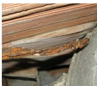
5.1: Corrosión de alambres
