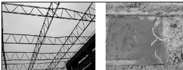
Figura 14. Prototipo de ladrillo: las cerchas de los forjados sufren deformaciones considerables y pequeñas fisuras de algunas piezas. Figure 14. Brick prototype: the trusses of the slab sustain considerable deformations and small fissures in some of the pieces.
