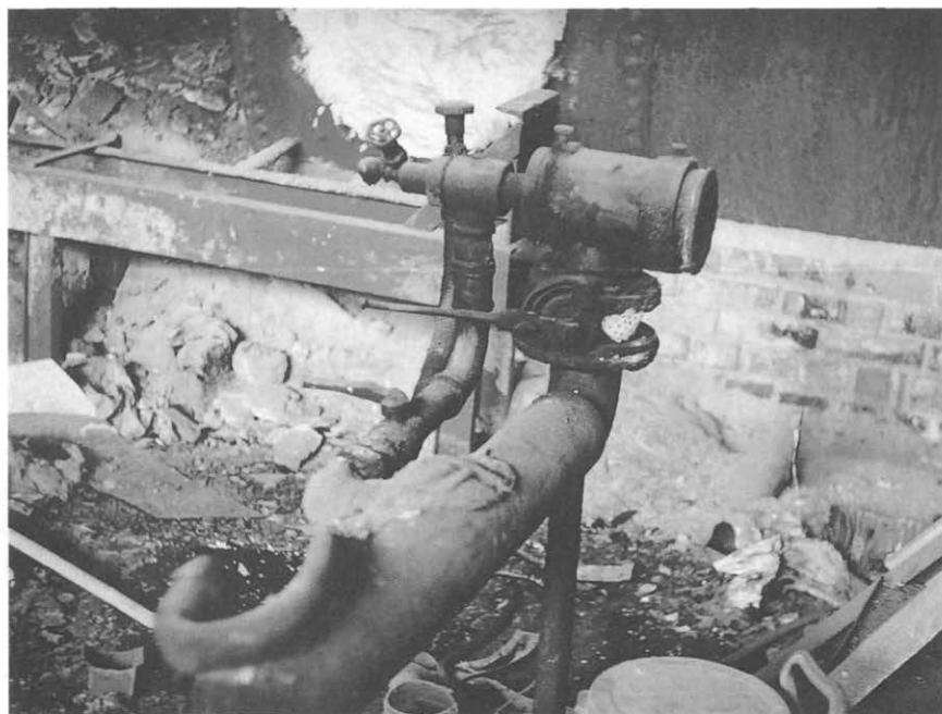
Figura 3. Detalle del quemador de fuel oil.
