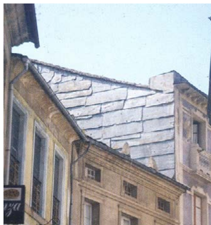
Fig. 3.11. Tabique pluvial gallego. (La fachada ventilada y ligera, Cristina Pardal / Ignacio Paricio)
