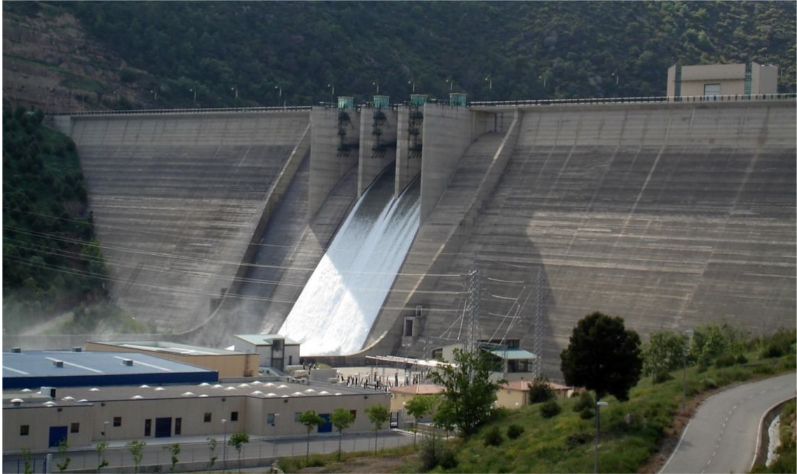
Figura nº 10. Presa vertiendo por la base del aliviadero (zona de compuertas)
