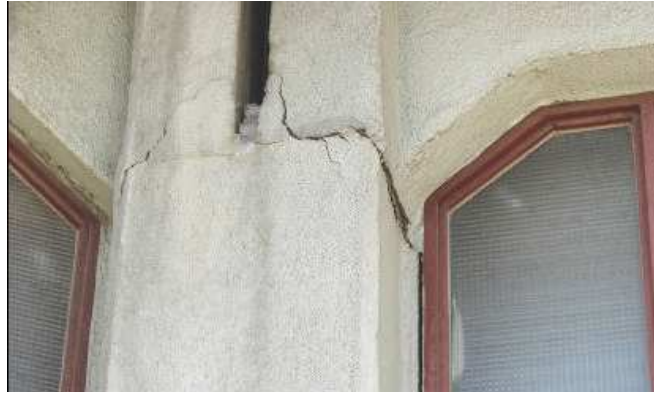
Fisuras y desconchones en vigas de cubierta, en zonas de juntas de dilatación Figura nº 7
