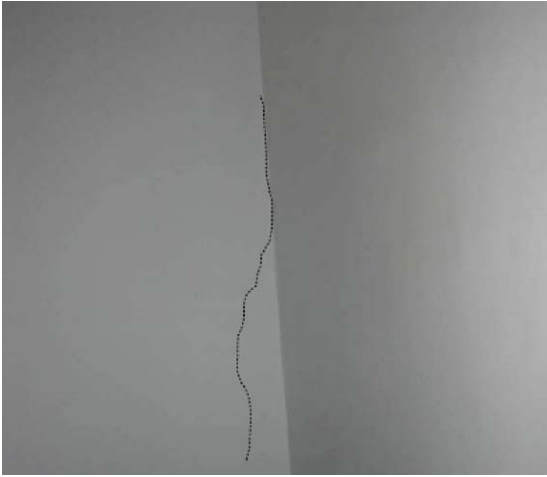
Fisura vertical en muro de fábrica de ladrillo Figura nº 2
