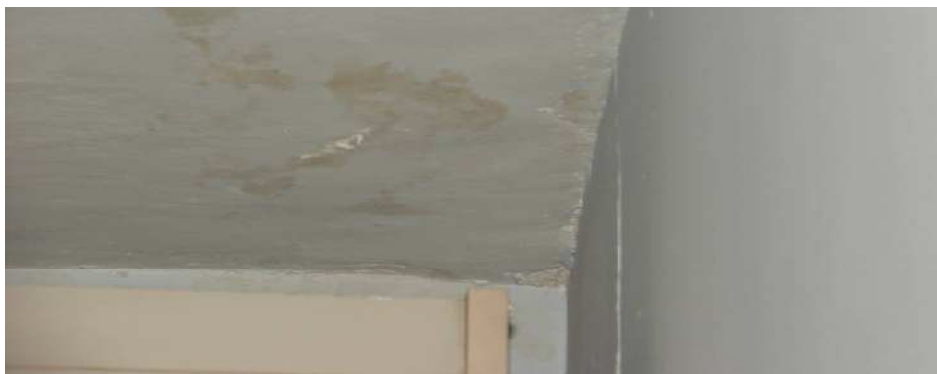
Humedades en encuentro de techo con cerramiento Figura nº 6
