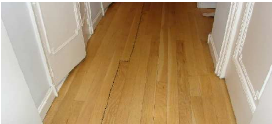
Junta de solado abierta Figura nº 5
