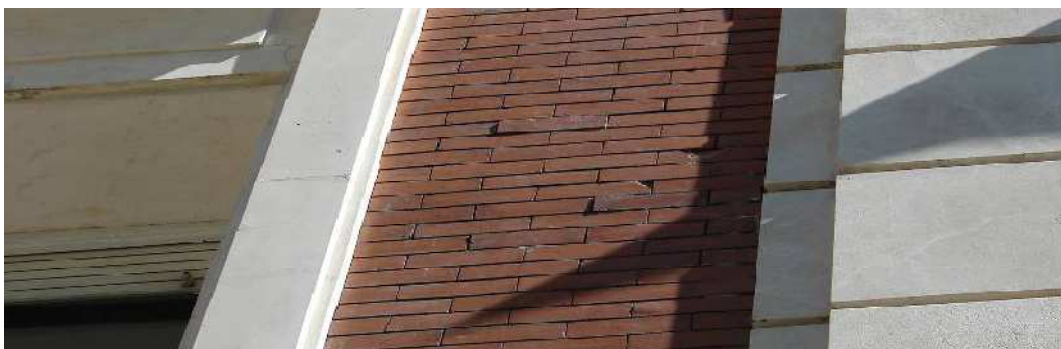
Desplazamiento de piezas de fábrica de ladrillo de la fachada Figura nº 8
