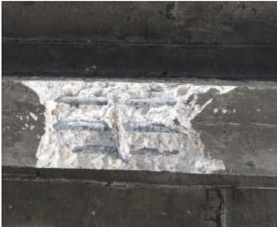
Calas realizadas para descubrir la armadura de positivos de los forjados Figura nº 10
