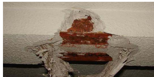
Cala en cara inferior del cargadero metálico Figura nº 18
