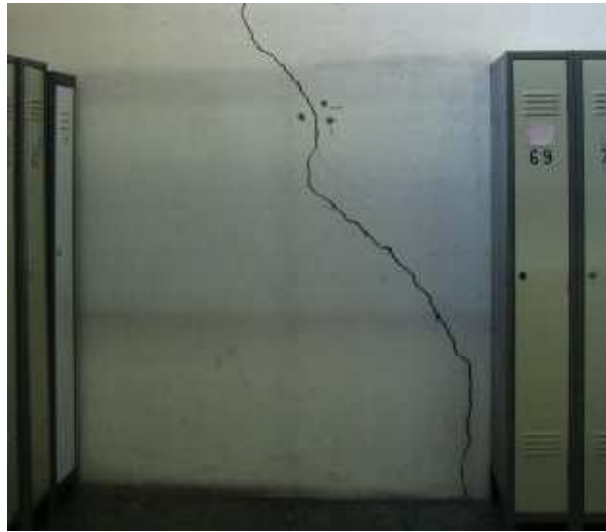
Fisuras en fachada y particiones interiores en la zona de esquina entre dos fachadas Figura nº 4
