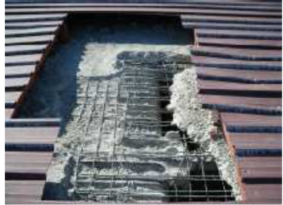
Detalle calas efectuadas en voladizos Figura nº 13
