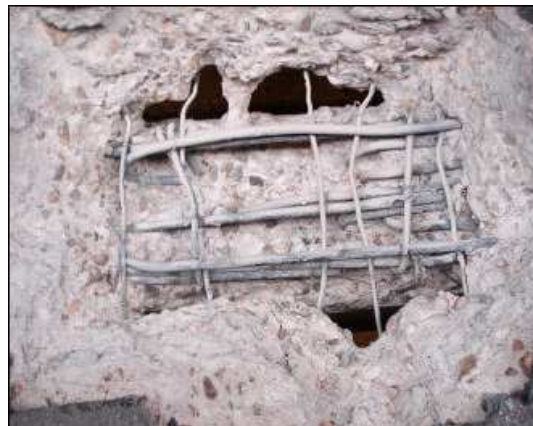
Calas realizadas en viga para descubrir la armadura de negativos Figura nº 15
