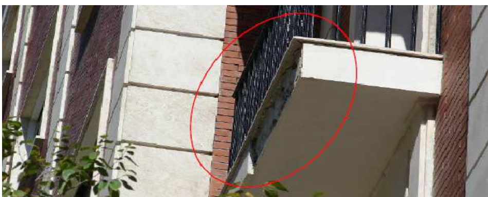
Desprendimiento de una pieza de aplacado de la fachada principal Figura nº 7
