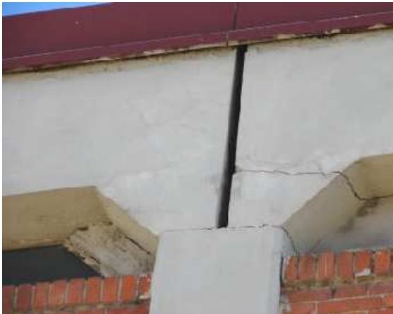
Fisuras en nudo pilar-viga de cubierta Figura nº 5
