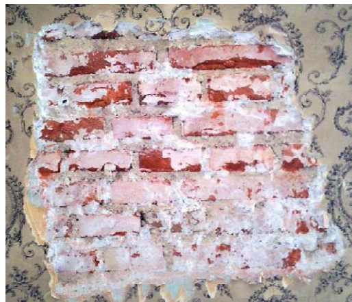
Cala en muro de carga de fábrica de ladrillo Figura nº 20
