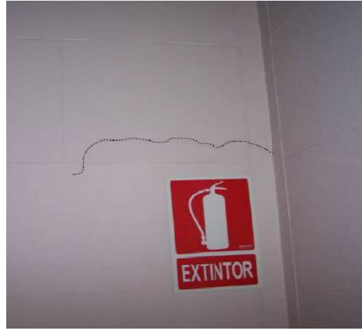
Fisura horizontal en muro de fábrica de ladrillo Figura nº 3
