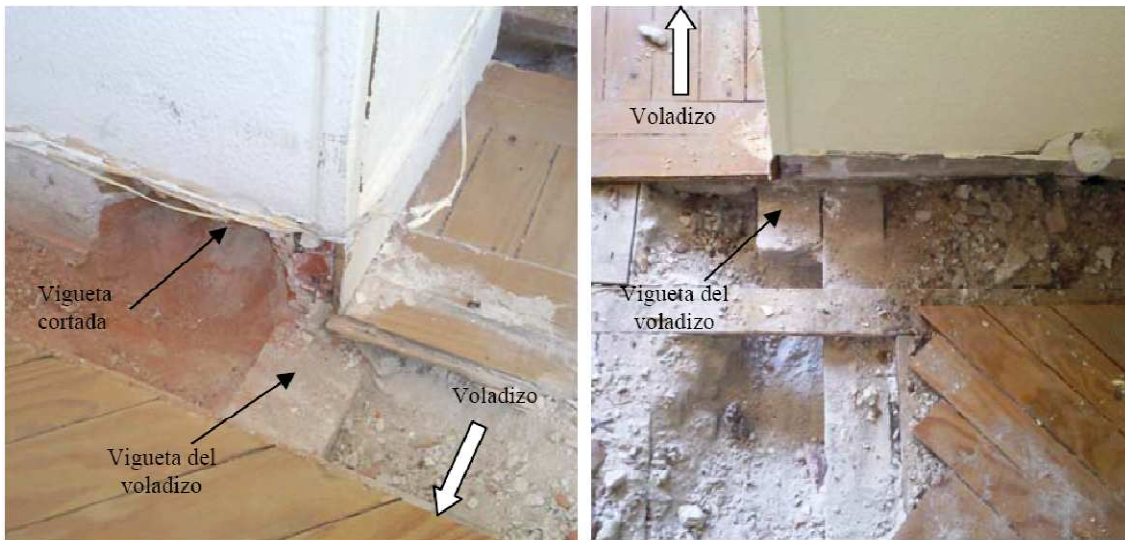
Cala en cara superior de forjado en voladizo Figura nº 13
