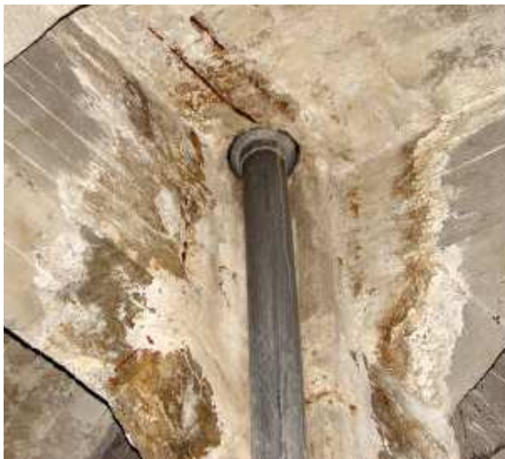
Fisuras y desconchones en elementos de estructura, que dejan armadura a la vista con síntomas de corrosión Figura nº 8
