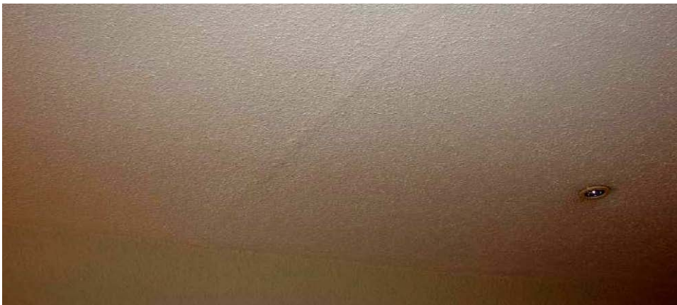
Fisura marcando la posición de la vigueta en techo, reparada Figura nº 4
