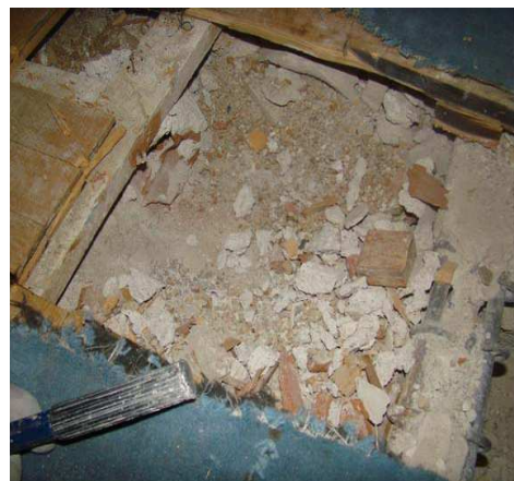
Cala en cara superior de forjado Figura nº 15
