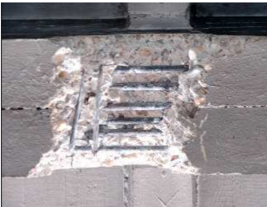
Cala realizada en una viga para descubrir la armadura de positivos Figura nº 14
