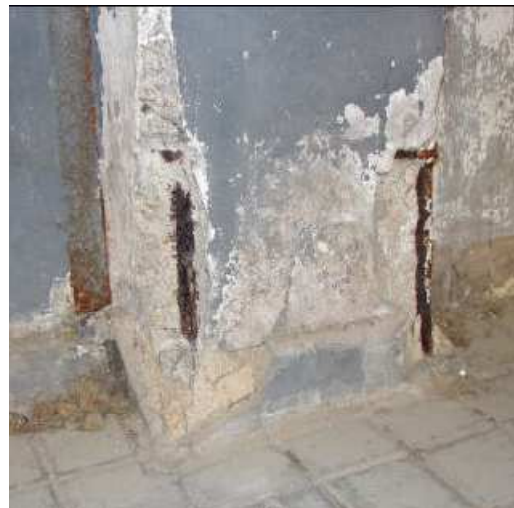
Fisuras y desconchones que dejan armadura a la vista con síntomas de corrosión en el arranque de un soporte Figura nº 9
