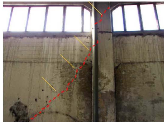
Fisura inclinada en cerramiento de planta primera, que continúa por el soporte Figura nº 6
