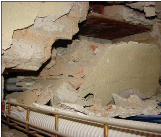
Vista desde la planta inferior del apoyo del pilar metálico que ha sufrido el descenso durante el refuerzo en la planta octava Figura nº 11
