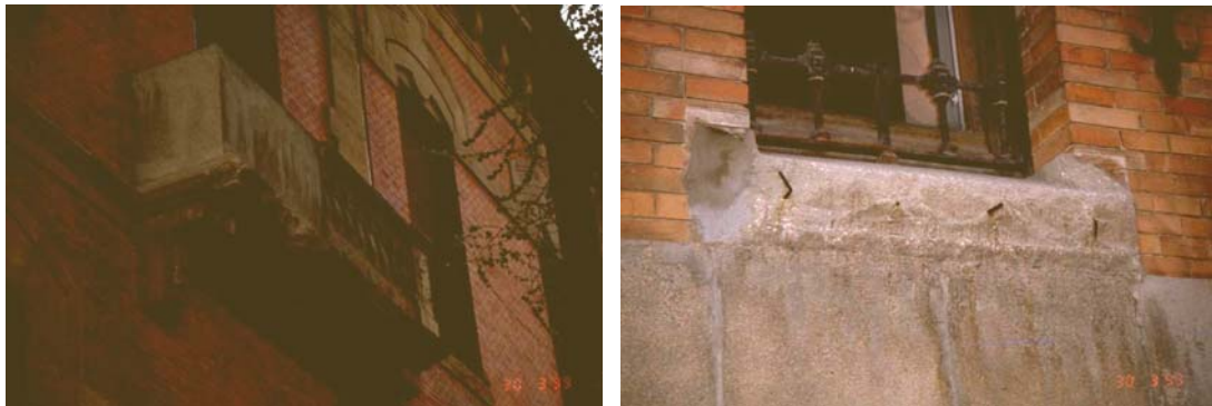
Fig. 4. Balcón volado parcialmente reparado Fig. 5. Vierteaguas parcialmente desprendido
