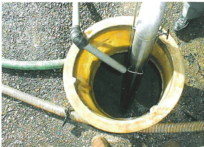
3.- Extracción del contenido del fermentador mediante bombeo.
