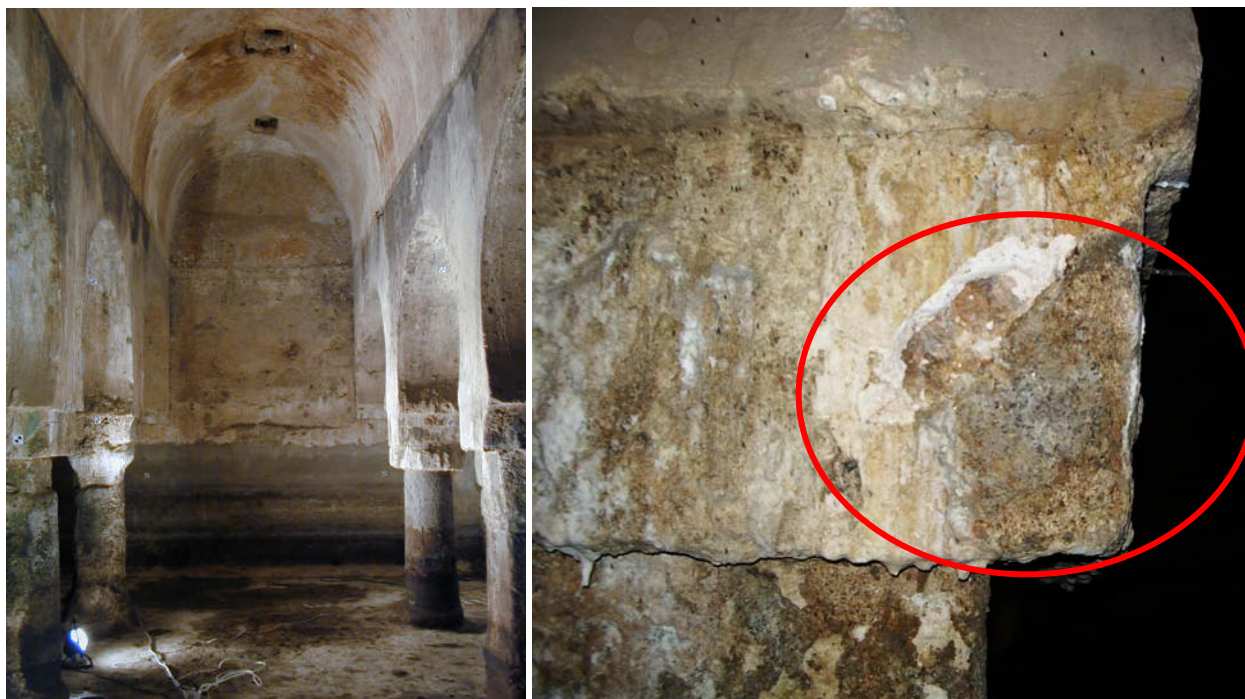
Fig. 8: a) Lucernas en la bóveda. Manchas de óxido de hierro. b) Muestra tomada de cimacio sobre soporte de piedra caliza, con pequeñas estalactitas en el borde. a) Openings in the vault. Iron oxide stains. b) Sample of cymatium attached to limestone with small stalactites around the edges.
