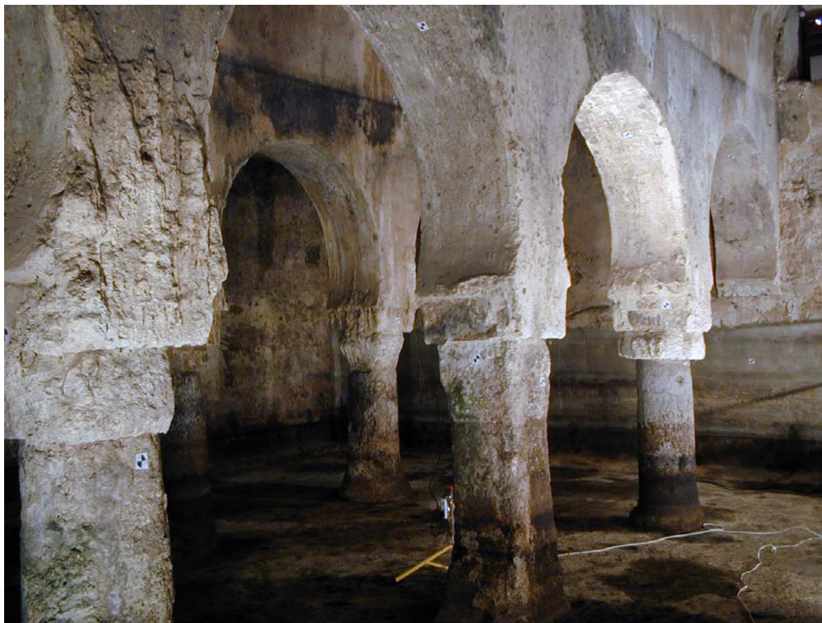
Fig. 7. Naves 3, 4 y 5. Superficies erosionadas con excoriaciones y manchas. Marcas de los niveles de sedimentación del agua en columnas y bóvedas. Costras en el pavimento. Naves 3, 4 and 5. Eroded, scaling, stained surfaces. Water marks on columns and vaults. Crust on the floor.
