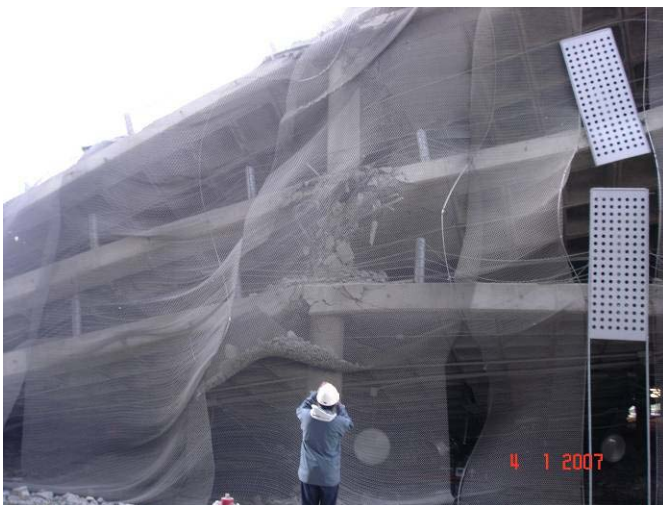
Fig. 3. Izquierda: Inclinación de los forjados provocado por el derrumbe.
