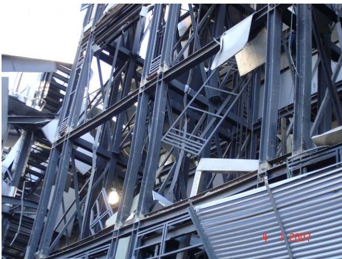
Fig. 5. Izquierda: Estado de la estructura de ascensor
