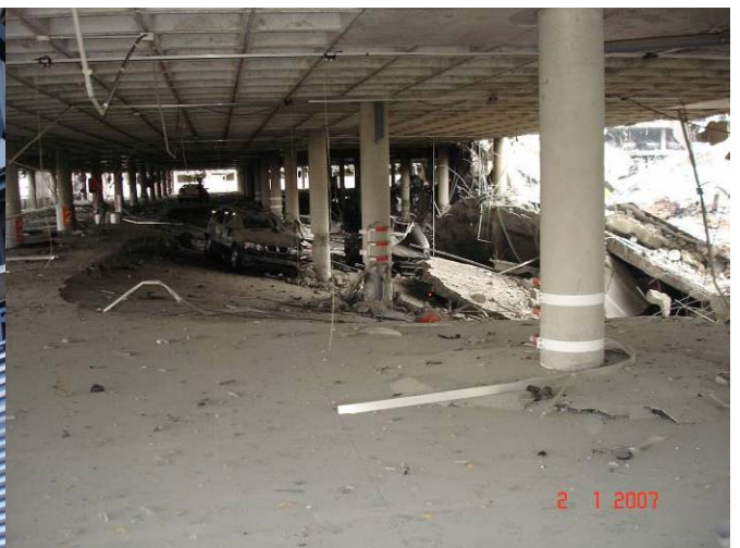
Derecha. Rotura de forjado
