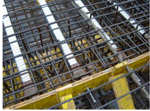
Fig. 7 Detalle acopladores de pretensado
