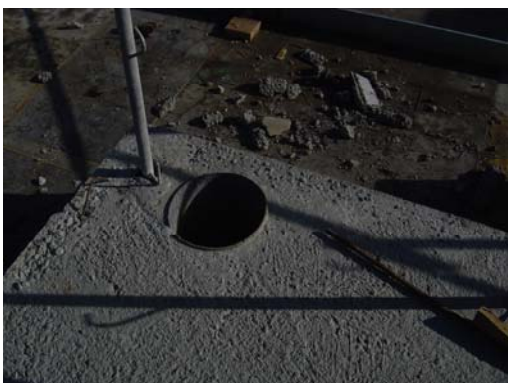
Fig. 12 Hueco para instalaciones ejecutado a posteriori
