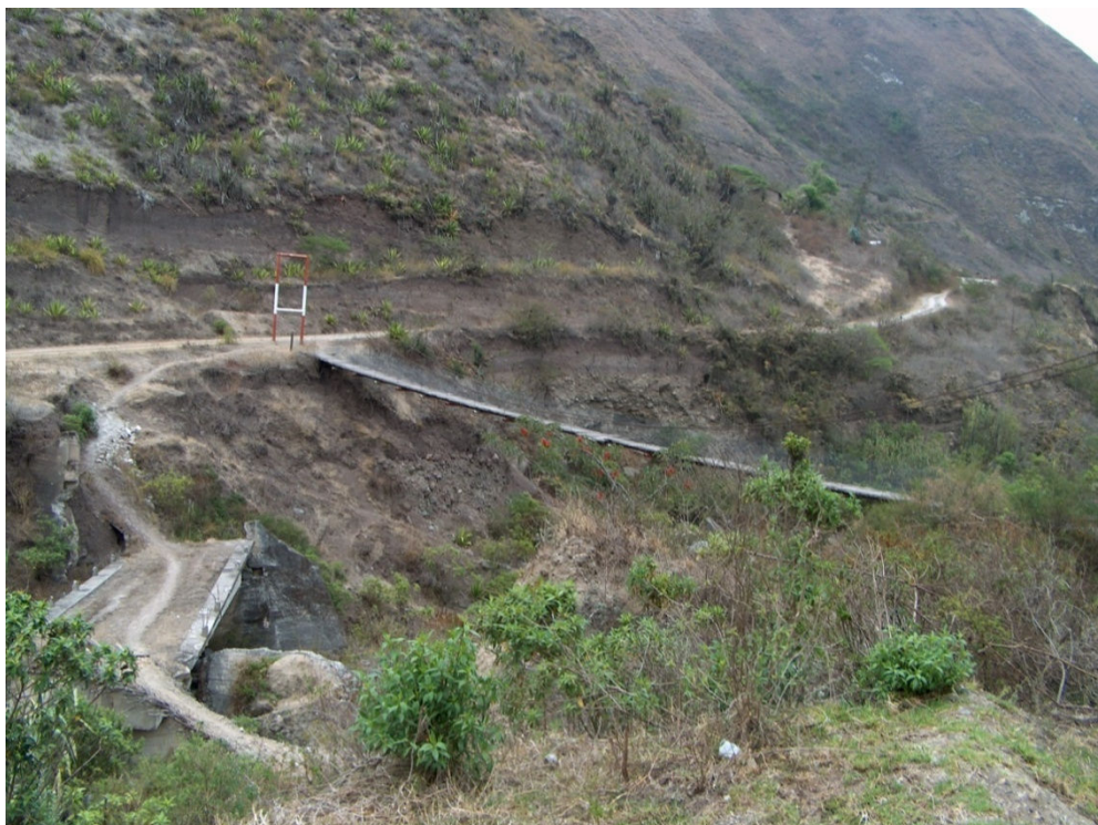
Ilustración VII.1: Puente derruido en Piñancay.
