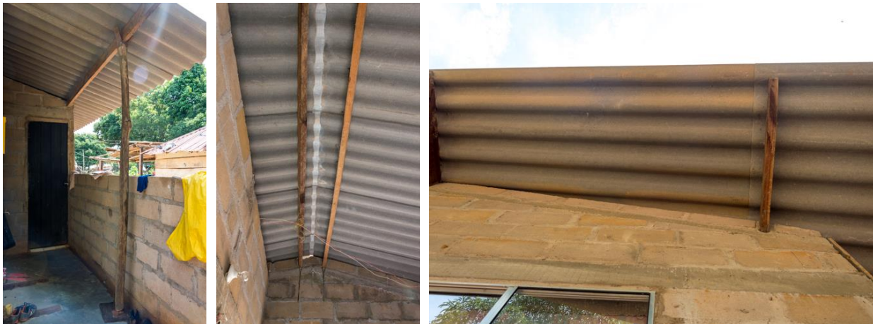
Figura 6.47. Errores constructivos en viviendas sociales rurales n°5
