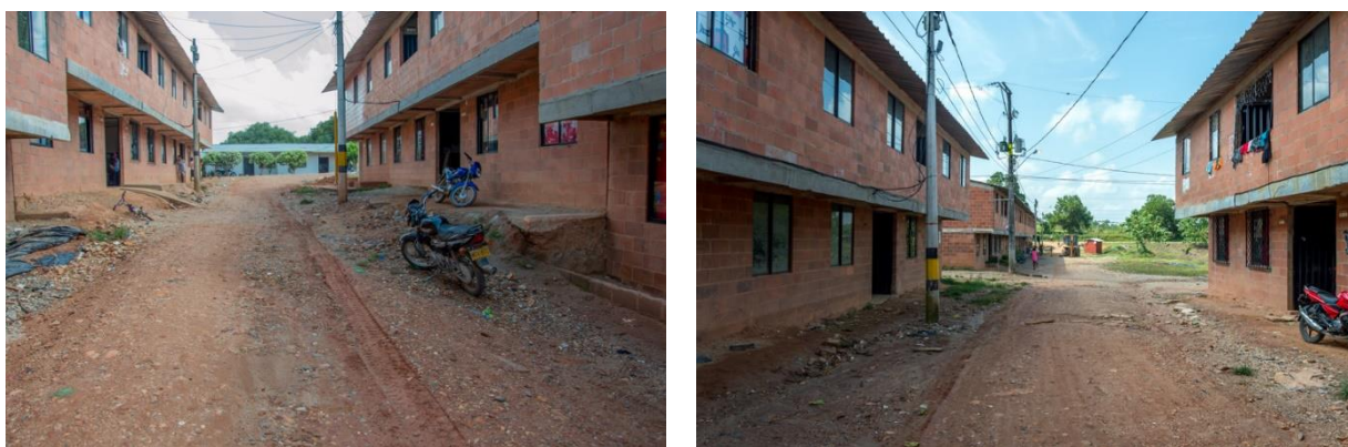
Figura 6.10. Falta de andenes y vías no terminadas, proyecto n°5, El Bagre
