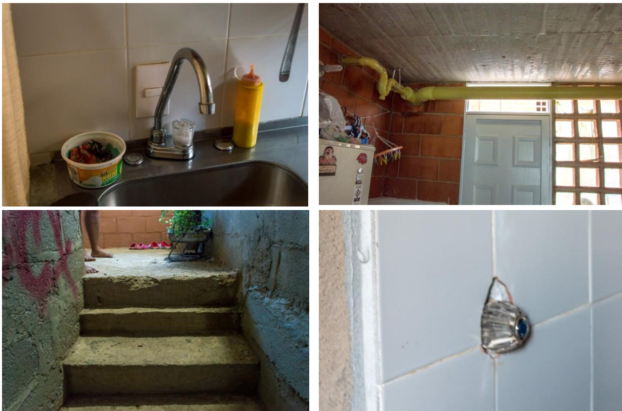
Figura 6.20. Fallas de diseño y errores constructivos en viviendas sociales, conjuntos n°2 (superiores) y 5 (inferiores)
