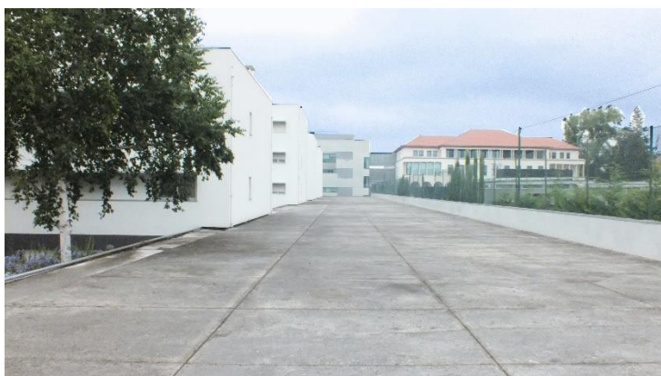
Fig. 29 - Situação atual da cobertura da garagem habitacional em Parceria e Antunes
