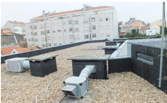
Fotografia 6: Elementos de ventilação
