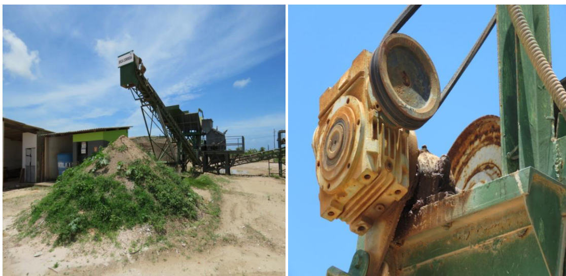
FIGURA 47. Detalhe Vegetação e Desgaste dos Componentes Mecânicos
