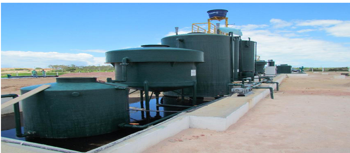
FIGURA 25. Estação de tratamento de percolado
