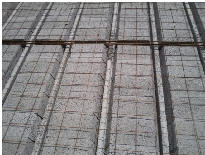
Imagem 15: Laje aligeirada e colocação da armadura e da armadura de distribuição (malha sol)
