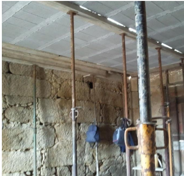
Imagem 14: Prumos de suporte a estabilizar a laje aligeirada, para se proceder à betonagem
