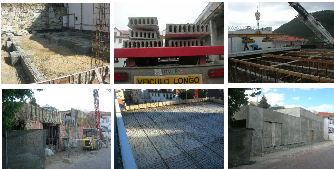
Figura 70 – Construção de sala de ensaios “Casa das Artes” na Rua Bernardo M. Leitão - Manteigas Autor dos projetos de especialidades e fiscalização – obra em execução – 10/2013
