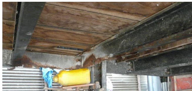
Figure 20 : Poutres rongées à cause de l'urine, maison à An Giang n°11
