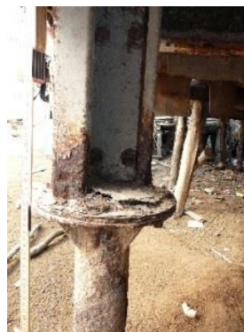
Figure 13 : Bas de colonne et pieu endommagés ; maison à Kien Giang n°10
