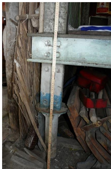
Figure 22 : Peinture antirouille sur le bas de la structure, maison à Kien Giang n° 8
