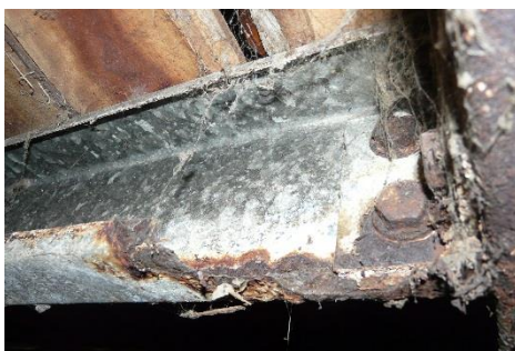
Figure 26 : Poutre rongée et boulons rouillés, maisons à Kien Giang n°2
