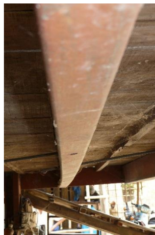
Figure 30 : Instabilité d'une poutre secondaire, maisons à An Giang n°6
