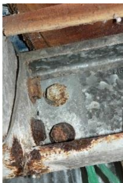
Figure 12 : Boulons corrodés ; maison à Kien Giang n° 2
