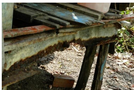
Figure 14 : Semelle inférieure rongée par la corrosion ; maison à Kien Giang n°11
