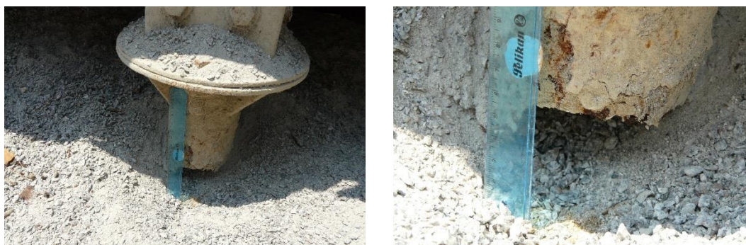
Figure 27 : Partie du micropieu cassé par la corrosion, maison à Kien Giang n°12
