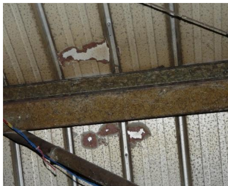
Figure 21 : Trous dans la toiture, maisons d'An Giang n°10
