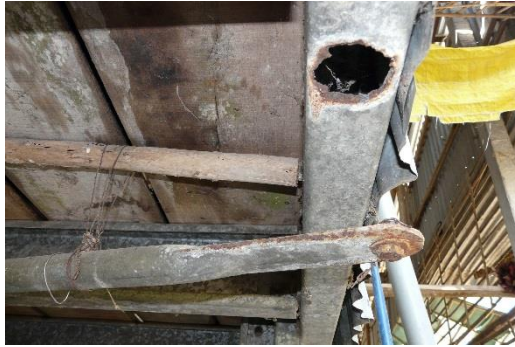
Figure 29 : Barre stabilisatrice détachée de la poutre principale, maison d'An Giang n°7
