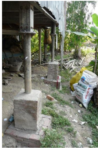
Figure 16 : Blocs de briques et ciment entourant les pieux, maison d'An Giang n° 18
