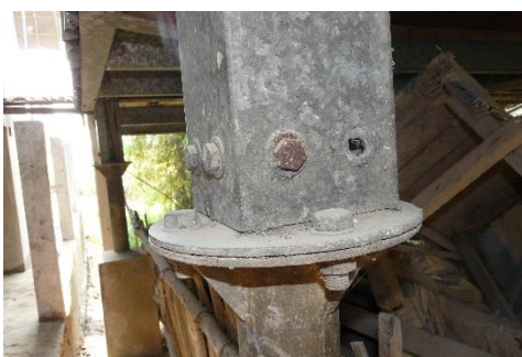
Figure 34 : Boulon manquant connexion pieu – colonne, maison à An Giang n°16
