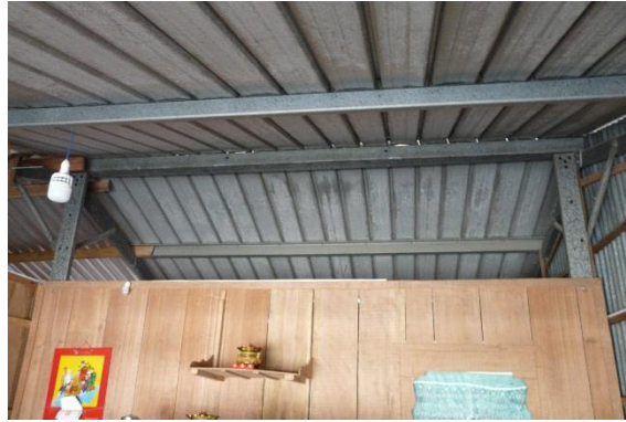
Figure 35 : Barres de contreventement du cadre du milieu manquantes, maison à An Giang, n°17
