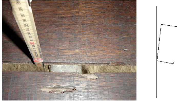
Figure 31 : Instabilité poutre secondaire, maison à An Giang n°7
