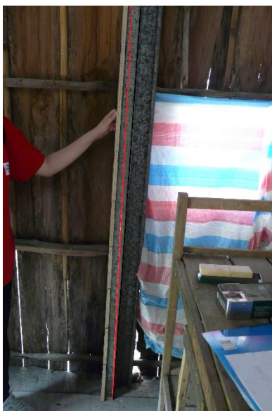
Figure 33 : Non verticalité d'une colonne, maison à Kien Giang n°5
