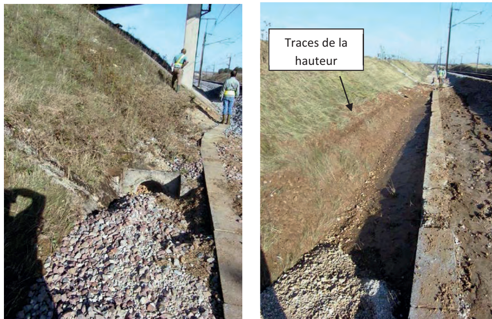
Figure 2 : Dégâts causés côté V2 (gauche) et V1 (droite).
