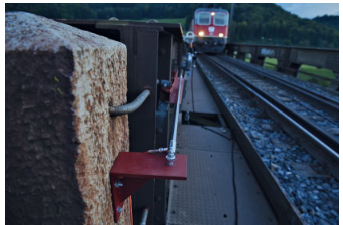
Bild 5. Am Widerlager Hüntwangen installierter Wegmessgeber Fig. 5. Extensometer installed at the Hüntwangen abutment
