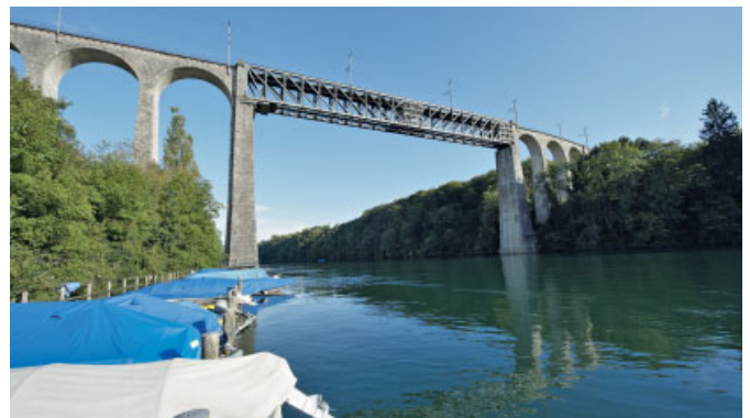
Bild 3. Stahlkonstruktion der Brücke Eglisau mit den im zentralen und rechten Bereich montierten Baugerüsten für die Sensorinstallation
