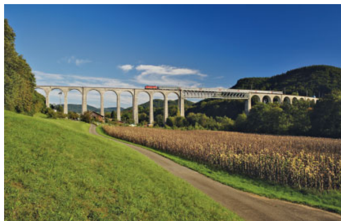
Bild 1. Gesamtansicht der Eisenbahnbrücke Eglisau inklusive der Vorlandbrücken und Stahlfachwerk Fig. 1. Overall view of the Eglisau Railway Bridge
