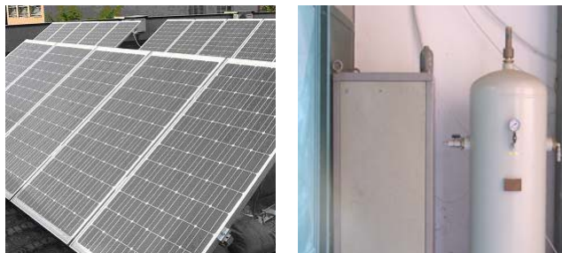
Fig. 13 Pannelli fotovoltaici e serbatoi di idrogeno
