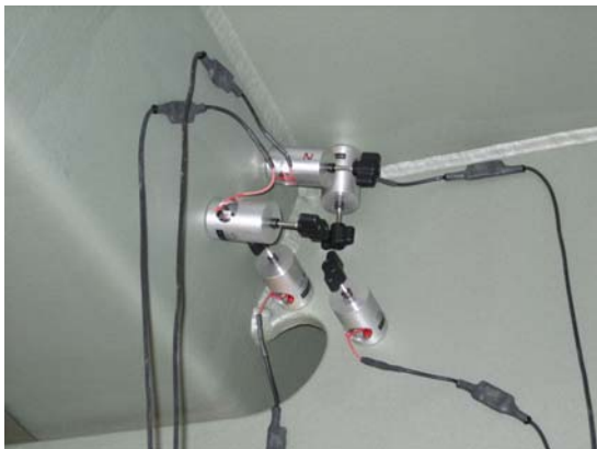
Bild 9 : Reibungsmessstreifen an der orthotropen Platte
