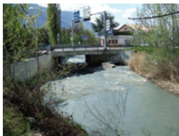
Figure 4, Pont de la Route Cantonale, avec coude et seuil. Vue depuis l'amont
