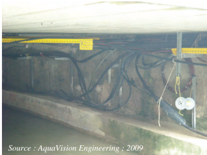
Figure 4. Câbles et tuyaux fixés sur le voûtage de Renens
