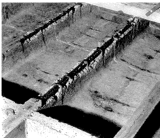
Corrosion des armatures en acier d'un plancher en béton préfabriqué. Photo Laboratoire de matériaux de construction, EPFL
