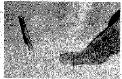
Fig. 3. Détail de l'attaque de la chape en mortier.
