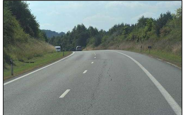
Figure 19 : Exemple d'incohérence des éléments d'une route : route à circulation bidirectionnelle mais présentant un profil autoroutier
