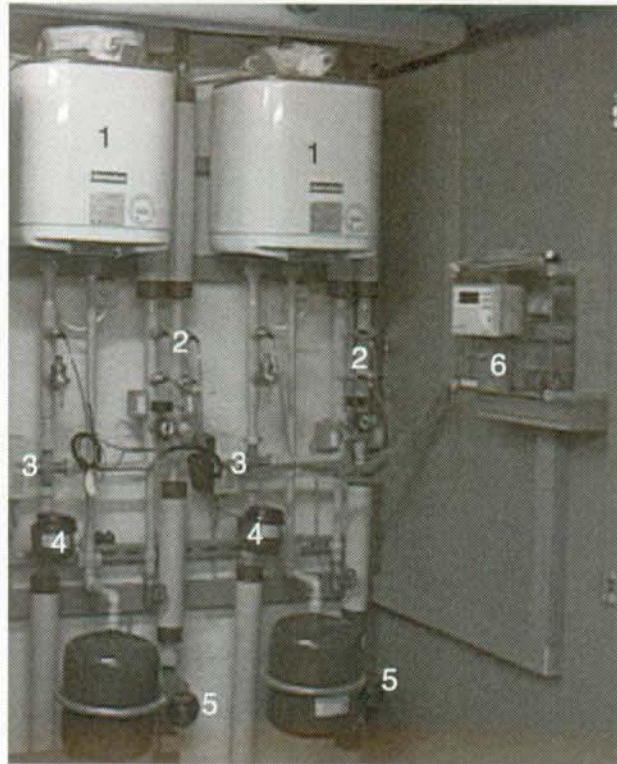
Figure 6 - 6: Circuits de distribution de la chaleur pour les locaux 03 et 04 (situés sous les locaux): Sur la photo, on distingue notamment: 1) les "chaudières"; 2) Les sondes plongeantes pour la mesure des températures de départ et de retour; 3) les vannes mélangeuses; 4) les débitmètres; 5) les circulateurs; 6) le module de contrôle conventionnel.
