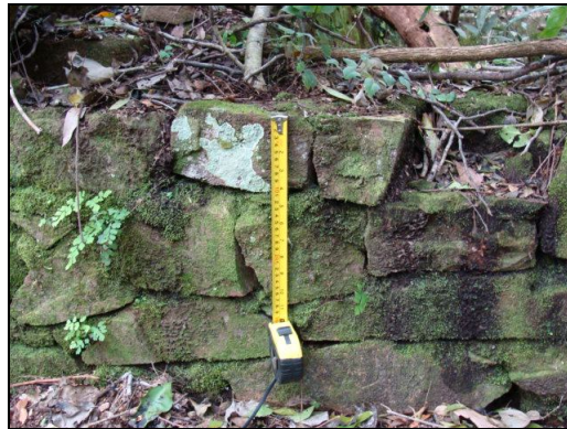
Foto 40 y 41. Deterioro de las superficies de las paredes. Crecimiento de líquenes, hongos y helechos.
