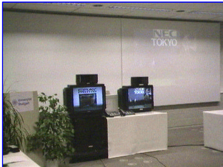
Gesamtaufbau der Videokonferenz-Anlagen
