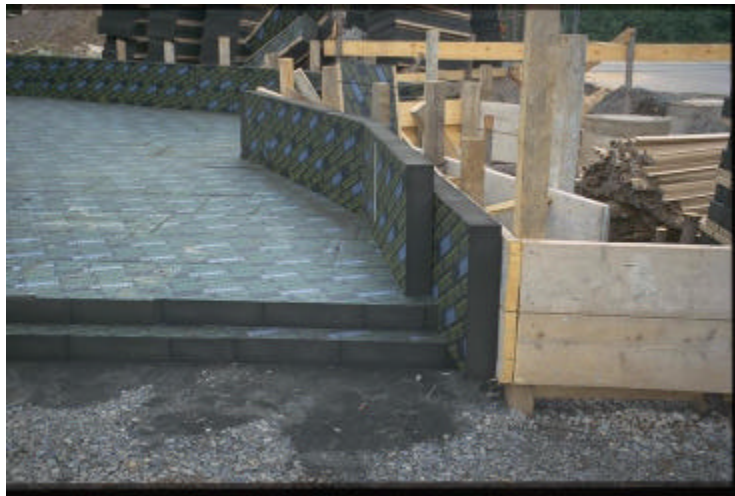
Abbildung 1.3: Eine insgesamt 24 cm starke Foamglass-Schicht dämmt das Gebäude gegen das Erdreich.
