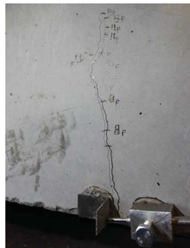
Figura 4. Registro y control de la evolución de la grieta.
