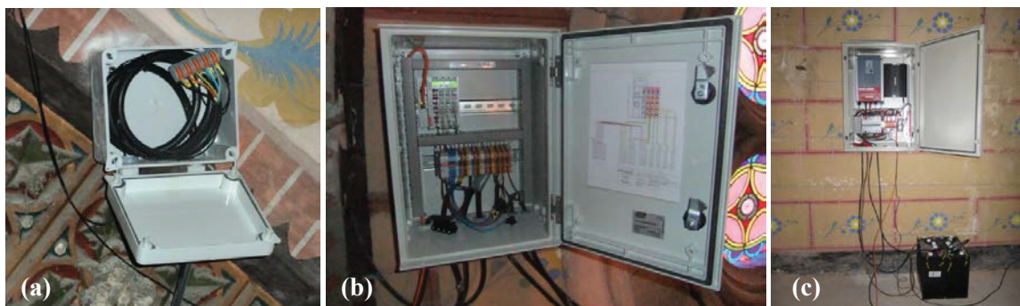
Figura 7. (a) Disposición final de “cajas intermedias” para proporcionar continuidad al cableado del sensor. (b) Vista interior de la Estación Remota nº 2. (c) PC Industrial y baterías de seguridad.
